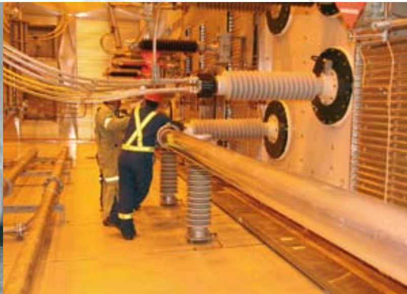
315 kV DC Ventilhalle / l'Outaouais Canada
