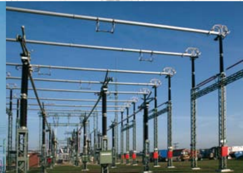
110 kV Stendal / Vattenfall Germany
